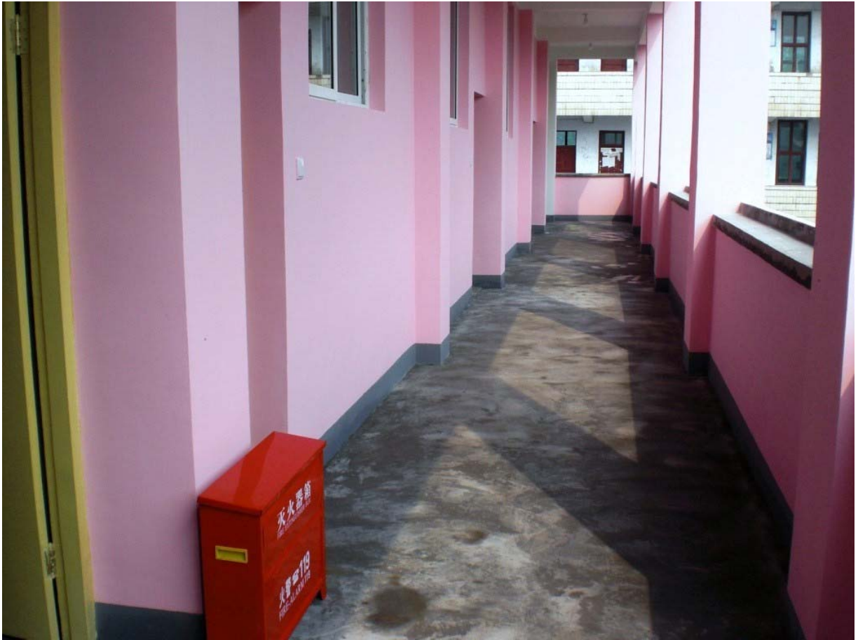
走廊里按规定配备了灭火设施
